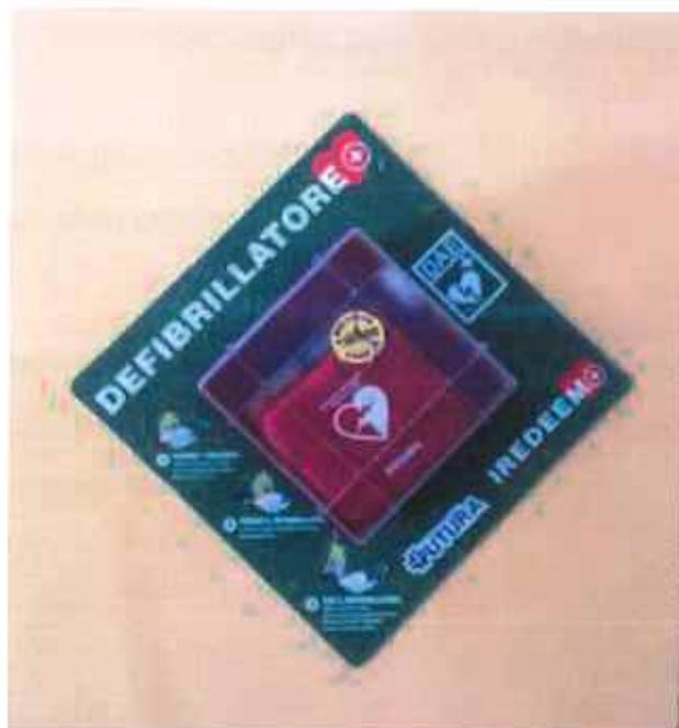
DEFIBRILLATORE POSIZIONATO NELL'ATRIO DEL PIANO PRIMO E SECONDO
