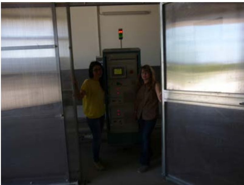
Pannello di controllo dell'apparecchiatura.
