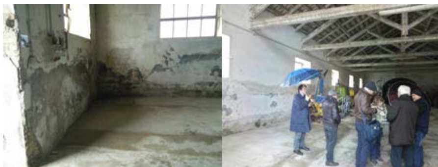
Parte del locale del magazzino Gualaneria destinato all’installazione del prototipo(a sinistra); discussione per la realizzazione dei lavori di adeguamento (a destra).
